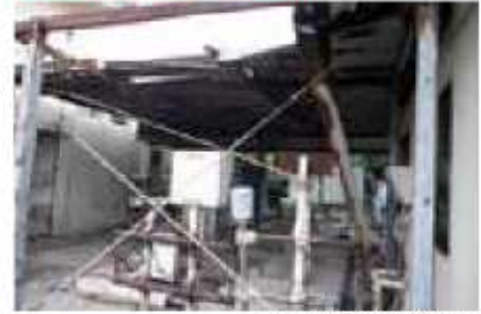
既設機械の機能低下
